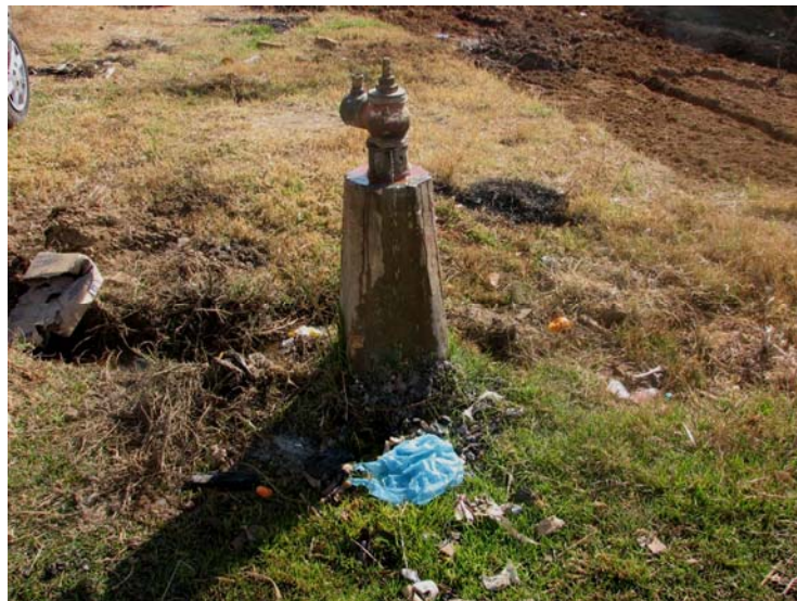
Figure 1-10: Sol Plaatje Standpipe 28
