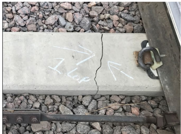
(d) Same crack after 120 laps
