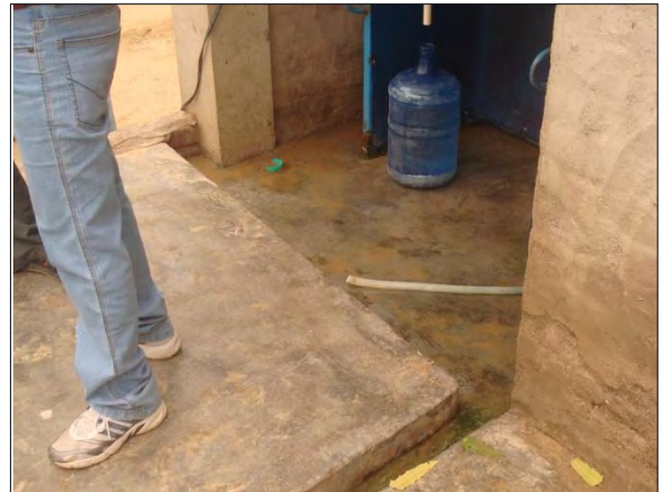
Rollsahabsar: RO brine discharge gutter
