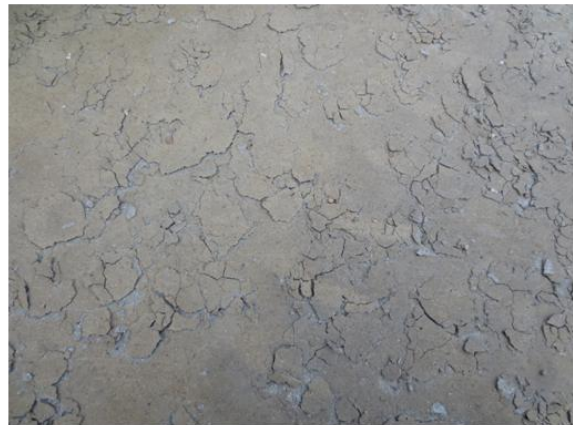
(d) Close-up view of the scaled surface
