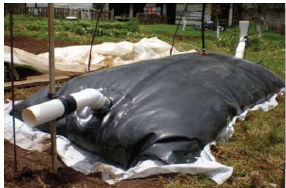
Figure 2: Actual plug-flow digester
